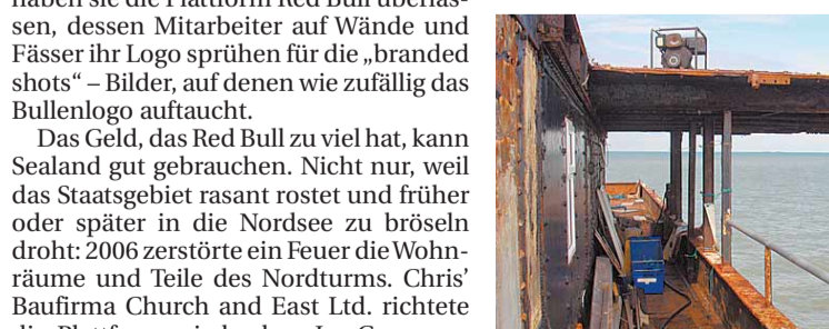
Sealands Elend: Rost und Korrosion machen dem Staat zu schaffen
